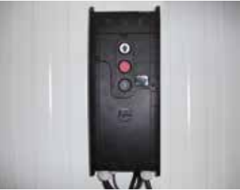
Cuadro de control de puerta rápida frigorífica.
